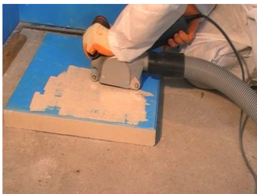
Retrait de peinture sur béton
